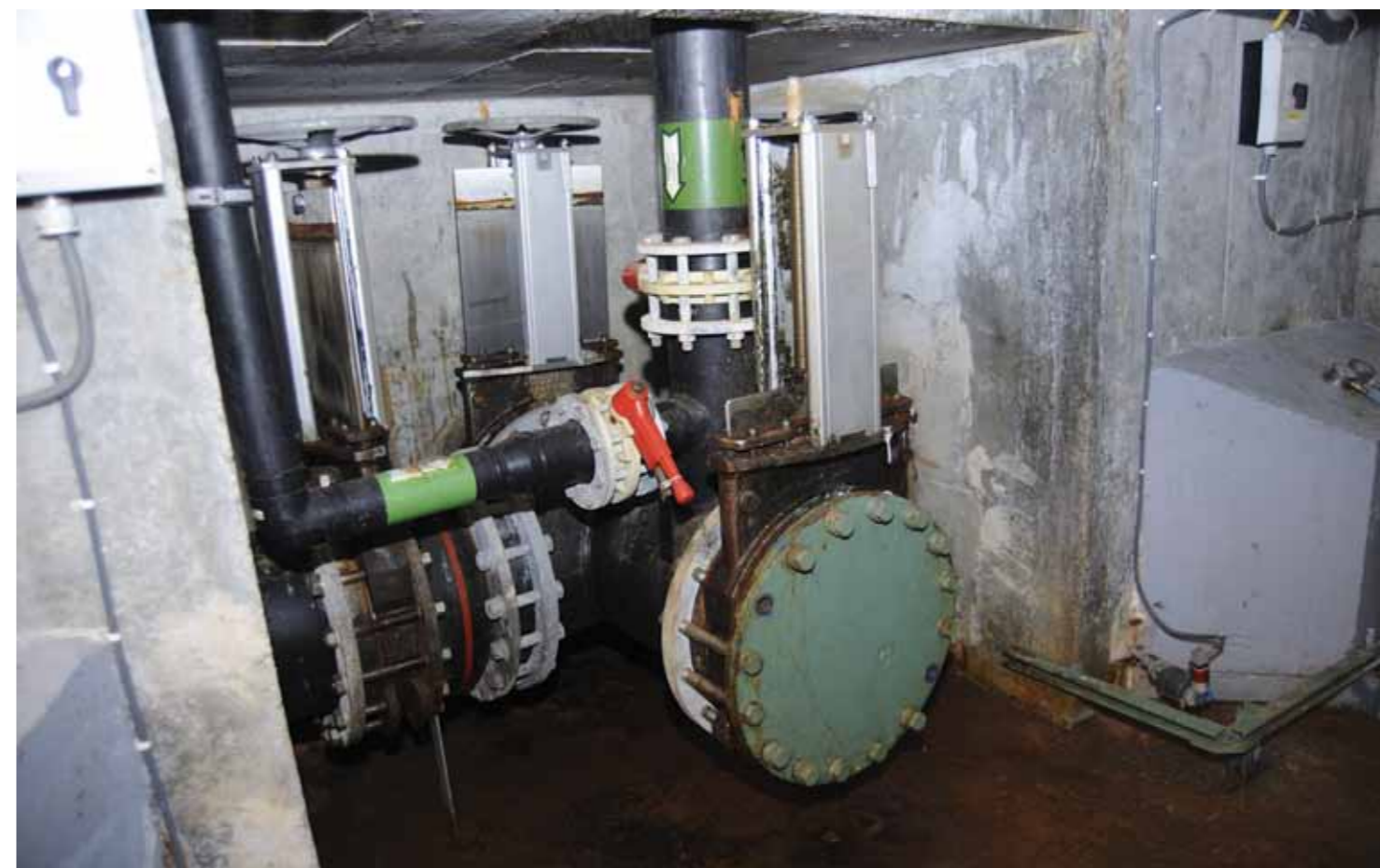
960 M: Et par vindeltrapper ned fra varmesentralen finner vi rørene som går 960 m ut i fjorden for å hente sjøvann fra ca 52 meters dyp.
